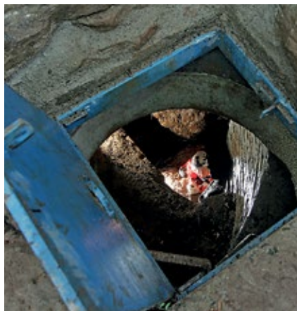
Schnellenbach Erdfall (Foto: Stefan Voigt)
