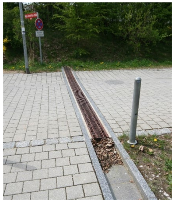
Abbildung 23: Blockierter Fließquerschnitt durch Ablagerungen vor einer Kastenrinne
