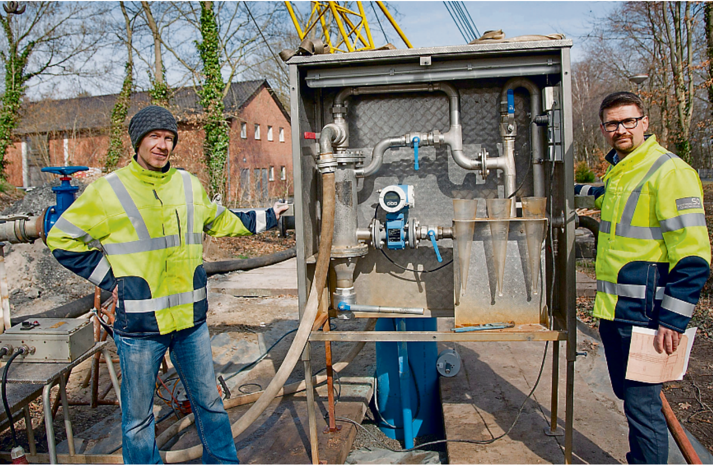
Jörg Viefhues (r.), Fachbereichsleitung Gas-, Wasser- und Wärmenetze, mit André Mölleken, Wassermeister der Stadtwerke Ostmünsterland und Leiter des Wasserwerks (l.), stehen an der mobilen Entsandungsanlage. Fotos: Bernd Pohlkamp
