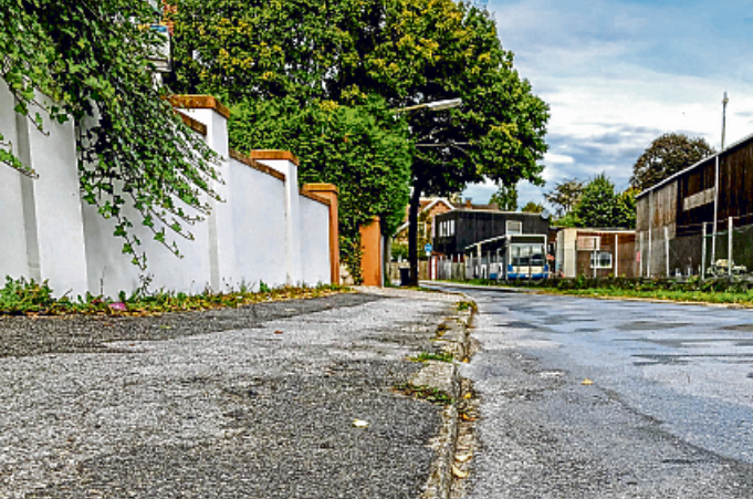
Die Mühlenstraße ist in einem erbärmlichen Zustand. Das wird sich in den kommenden Wochen und Monaten ändern. Foto: Archiv
