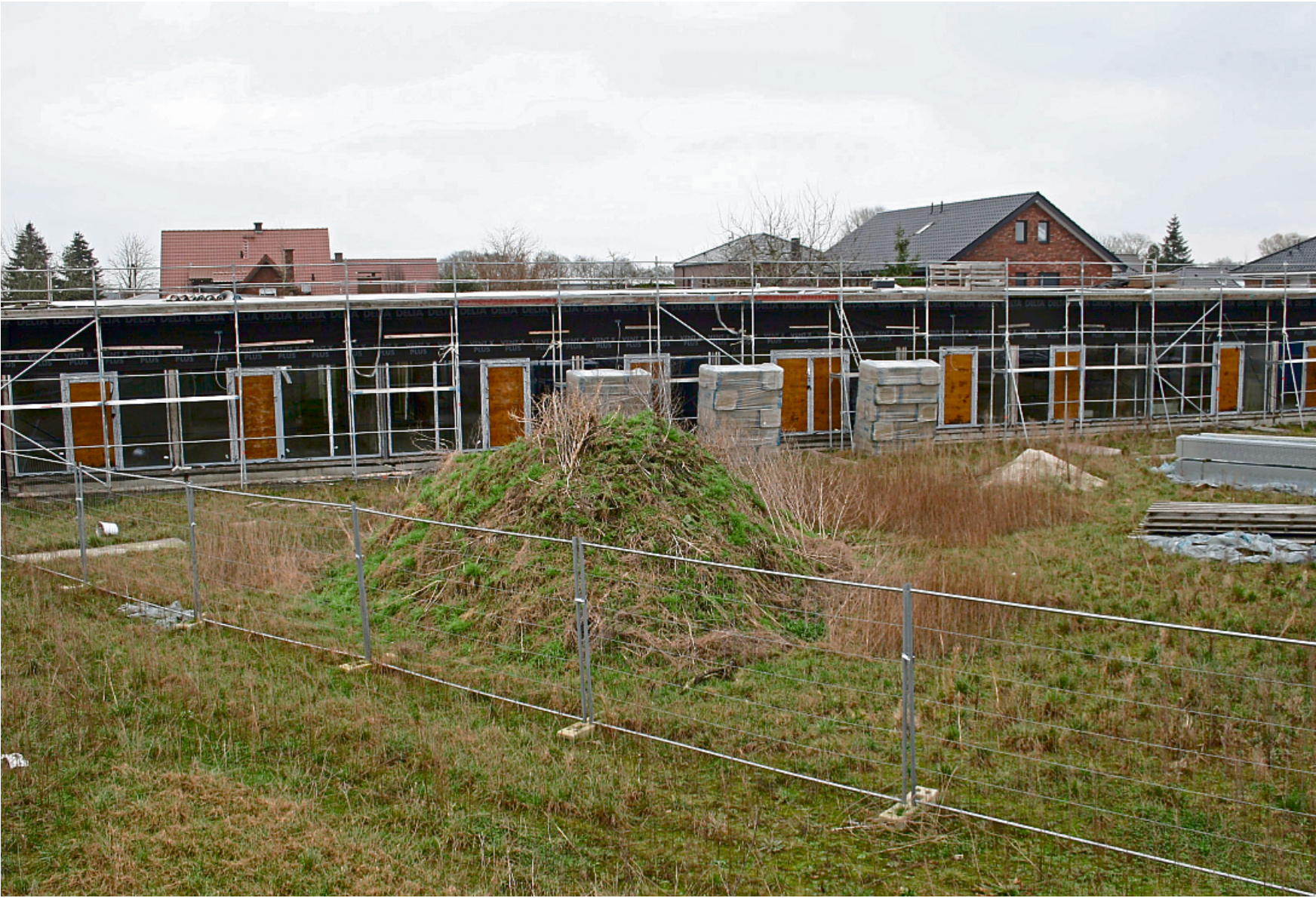
Eine Bauchlandung erlebte die Gemeinde mit dem Investor der Kita „Biberbande“, die im Kohkamp III entstehen sollte. Bis heute steht die Bauruine unangetastet dort. Eine neue Kita soll jetzt in unmittelbarer Nähe gebaut werden.
