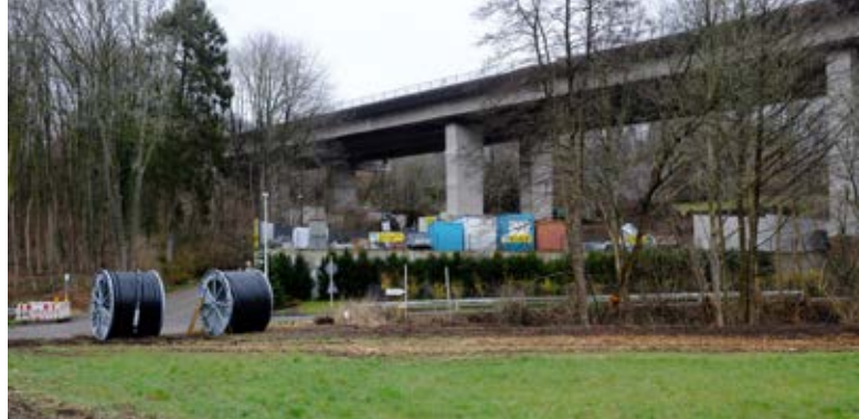
Die Autobahnbrücke über das Hammertal ist marode und muss ersetzt werden.
