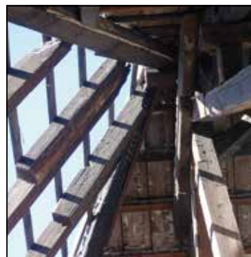
Brandschaden am Dachstuhl.
