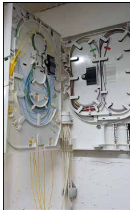
Übergabepunkt im Keller: in den sichtbaren gelben Kabeln befinden sich die haarfeinen Glasfasern, über die mittels Lichtsignal Daten übertragen werden.
