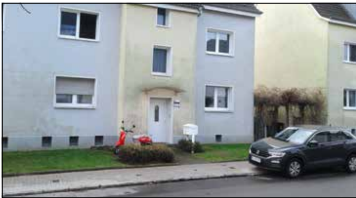
Algen und Moos ließen die Fassaden unansehnlich werden.
