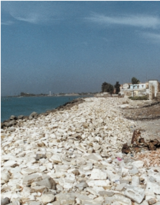
In der Stadt Rufisque sind bereits viele Häuser und Grundstücke dem Meer zum Opfer gefallen. Der Deich aus aufgehäuften Felsbrocken soll Schutz bieten.
