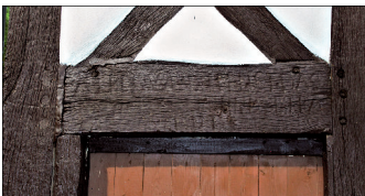
Abb. 18: Die linke Seitentür des Böltener-Hofes: Die Inschrift ist so stark verwittert, dass sie nicht mehr zu erfassen ist.
