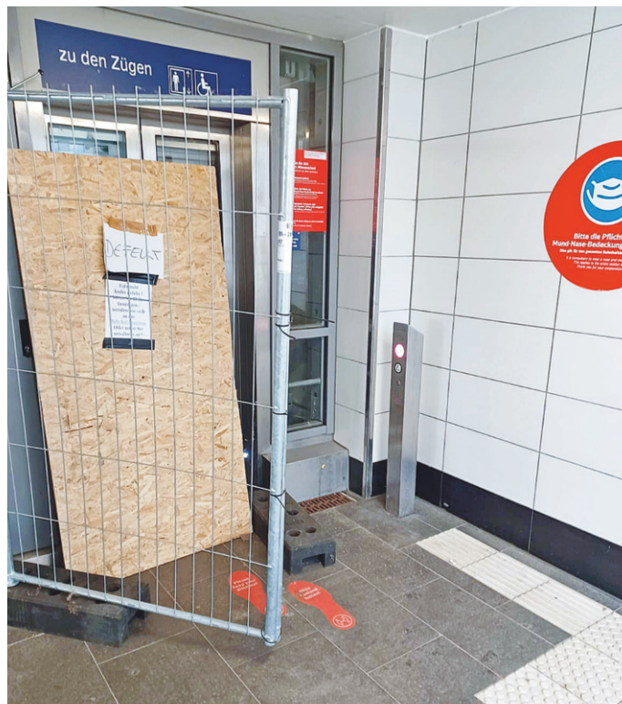
Wegen des defekten Aufzugs soll sich die Verwaltung mit der Bahn in Verbindung setzen und kurzfristig für Abhilfe sorgen, beantragt die FWG-BBL-Fraktion.
