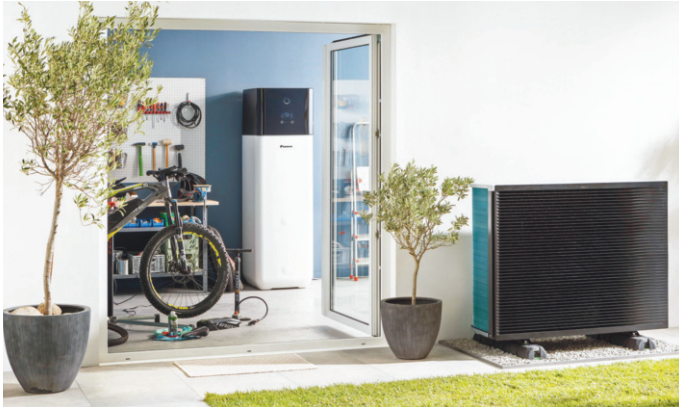
Der Einsatz umweltfreundlicher Wärmepumpen ist in nahezu allen Gebäuden möglich, auch in älteren Eigenheimen.
