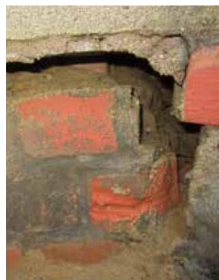
Schaden vor der Schachtsanierung
