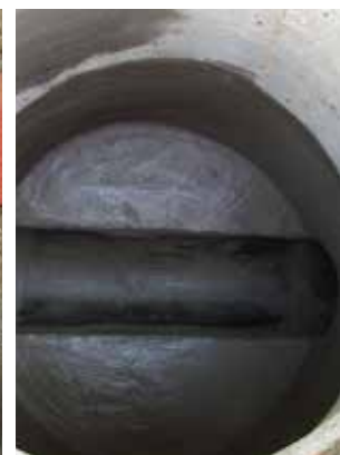
Schaden nach der Schachtsanierung
