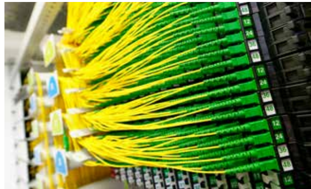
Im Inneren des Glasfaserhauptverteilers: Die „Adern“ aus reiner Glasfaser innerhalb des ‚POP's (Point of Presence) von Deutsche Glasfaser. (DG)
