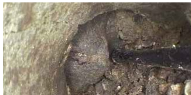
Einsturz, Boden sichtbar
