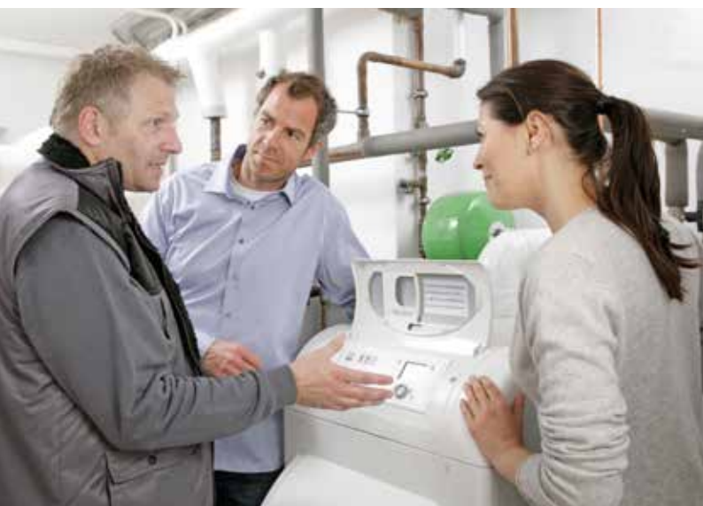
Öl-Brennwerttechnik ermöglicht deutliche Energieeinsparungen bei überschaubaren Investitionen. Öl-Brennwertgeräte arbeiten höchst effizient und nutzen zu fast 100 Prozent die Energie, die im Brennstoff steckt. Foto/Grafik: bpr/IWO
