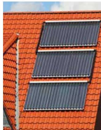
Die Sonne unterstützt das Heizsystem im Eigenheim tatkräftig mit Raumwärme und bei der Warmwasserbereitung. So lassen sich Heizkosten senken und die Umwelt wird geschont. txn-p txn-Foto: B.A.U.M./fotolia
