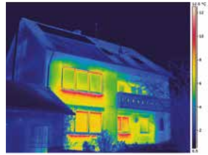
txn-p. Bei kalten Außentemperaturen kann eine Wärmebildaufnahme des Eigenheims gemacht werden. So sind energetische Schwachstellen im Wärmeschutz leicht zu erkennen. Foto: RWE/bxn
