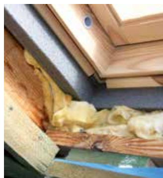
Risse entstehen zum Beispiel beim Einbau von Fenstern, besonders im Dach.
