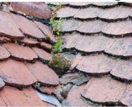
Ist das Dach in einem schlechten Zustand, können Sturmschäden richtig teuer werden. Wurde die Wartung vernachlässigt, zahlt die Versicherung unter Umständen nicht.
