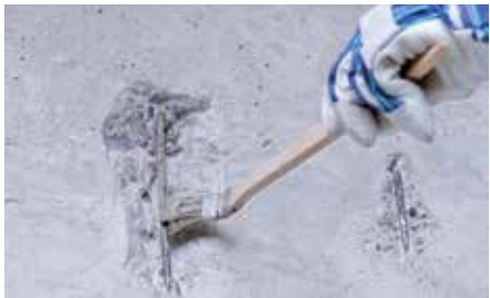
Korrosionsschäden am Bewehrungsstahl in Betonbauteilen sollten schnellstmöglich behoben werden. Foto: Saint-Gobain Weber/txn-p
